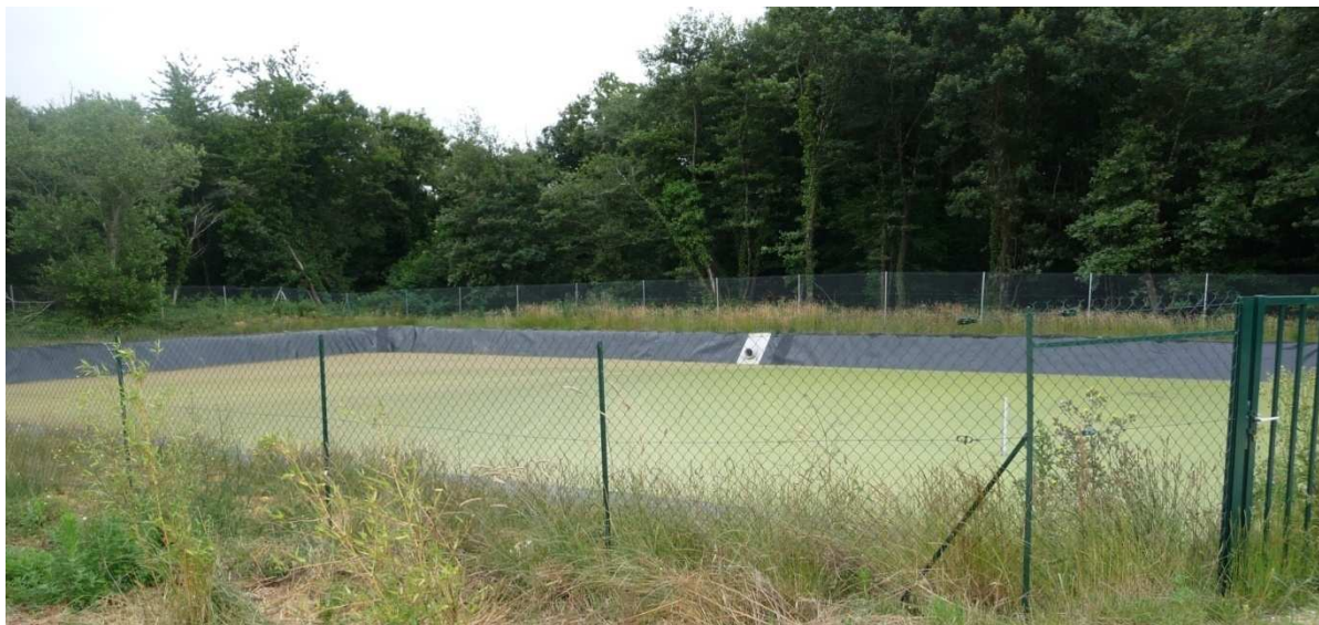
Figure 3 : Bassin tampon des eaux traitées avant rejet au milieu naturel
